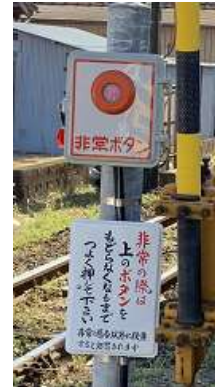
押ボタン式踏切 支障報知装置
